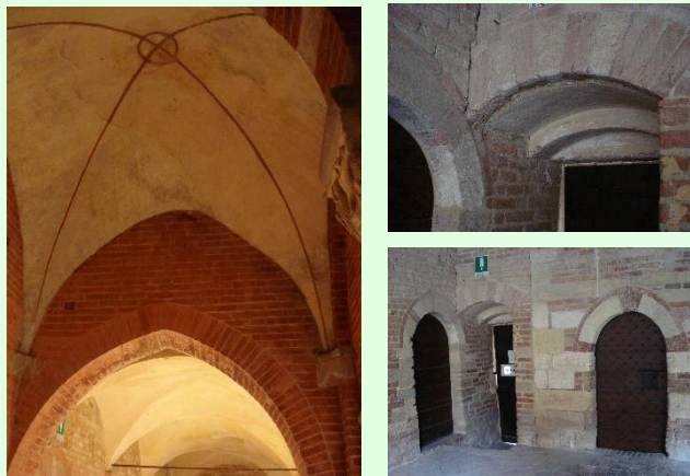
Irregolarità costruttive e rifacimenti
